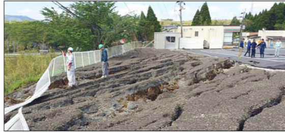
岩肌がむき出しになった崩落現場を望む。阿蘇大橋近くにあるコンビニエンスストア駐車場の地割れ。
