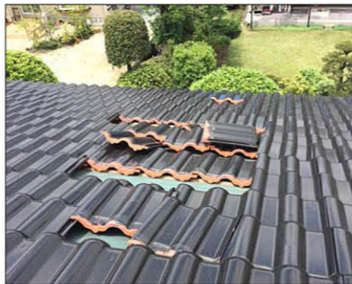
強い縦揺れに、屋根の中央の瓦が弾け飛んだ。
